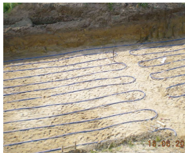
Zewnętrzna instalacja gruntowego wymiennika ciepła.
